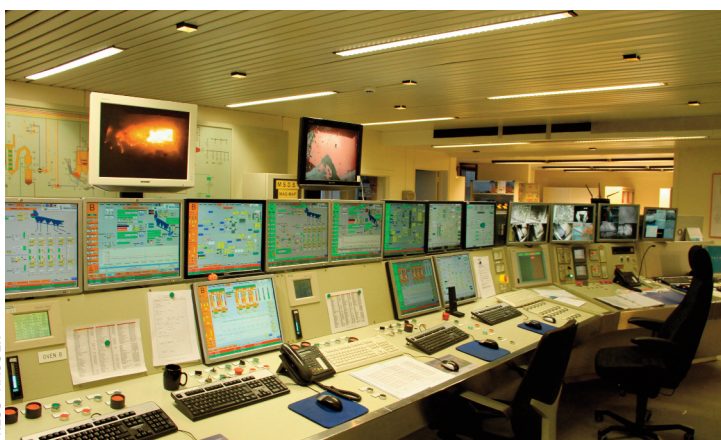
Un aperçu de la salle de contrôle de l'IVBO à Bruges.
