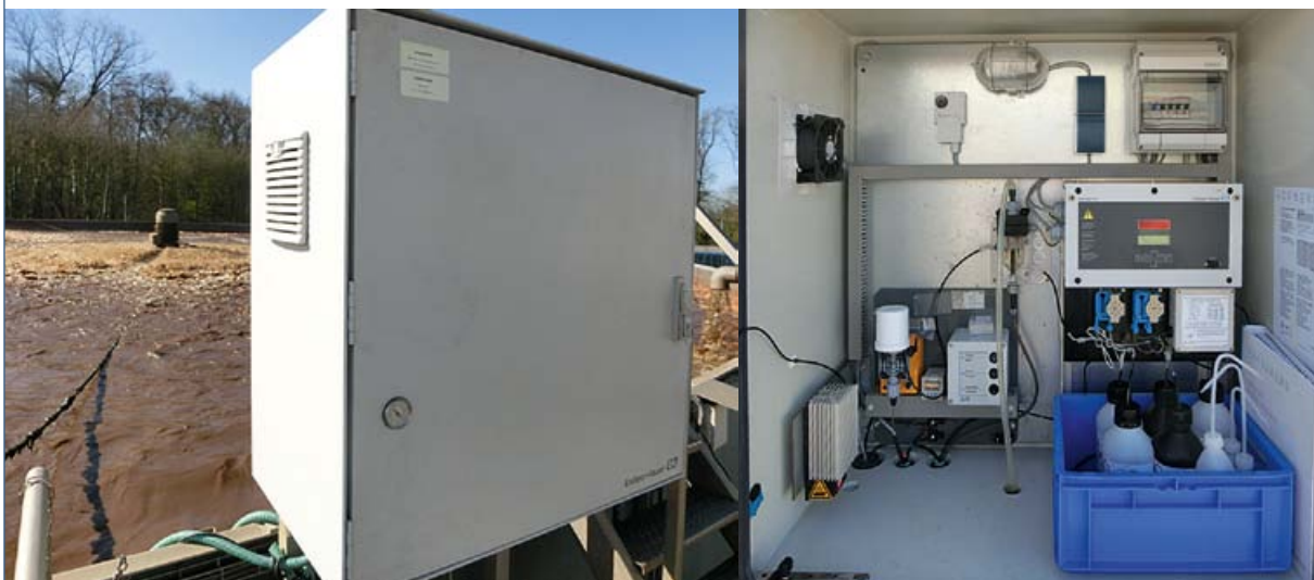
Photo à gauche: Le boîtier de l'équipement de mesure en ligne comprend un élément de chauffage et un système de ventilation pour préserver l'analyseur du gel et sa plage de température de fonctionnement.
