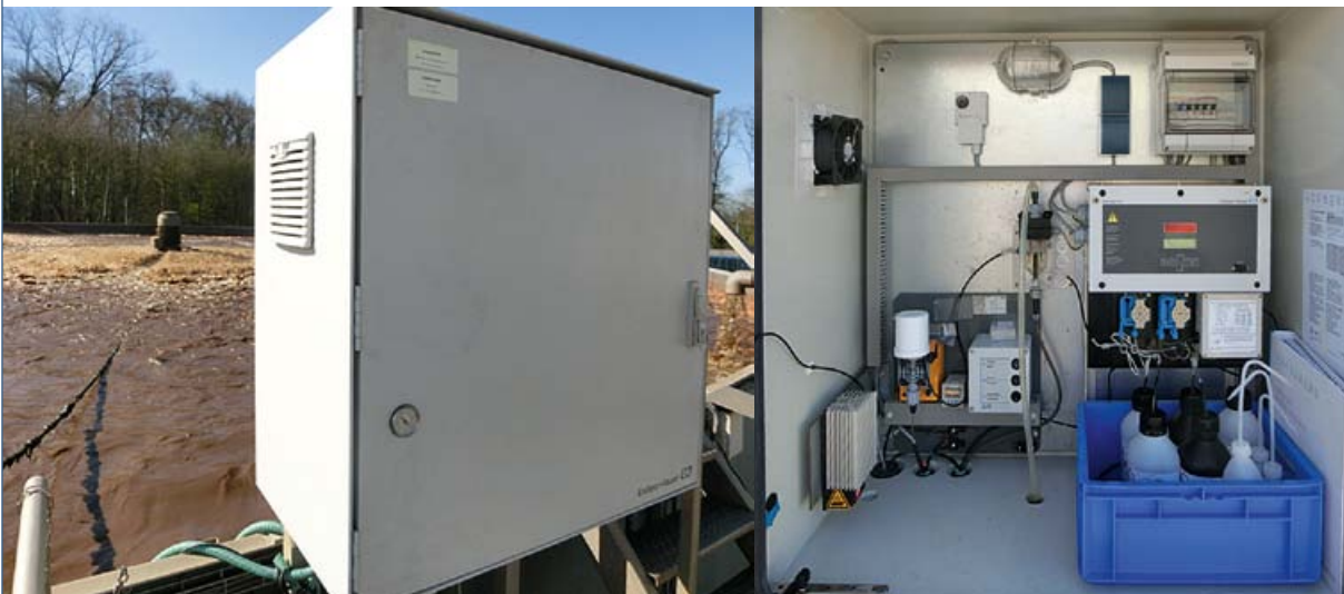
Foto links: De behuizing van de online meter is uitgerust met een verwarmingselement en ventilatiesysteem, zodat de analyser vorstvrij en binnen zijn temperatuurwerkingsgebied wordt gehouden.
